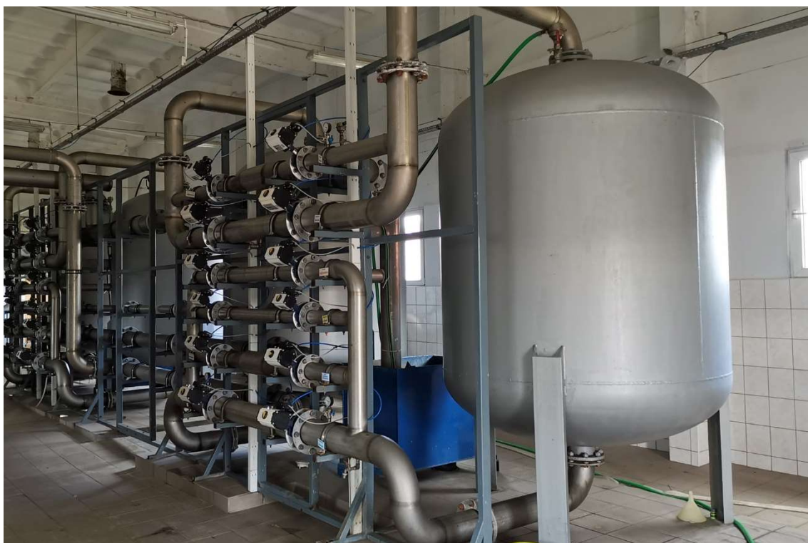
Stacja uzdatniania wody w Piątku
