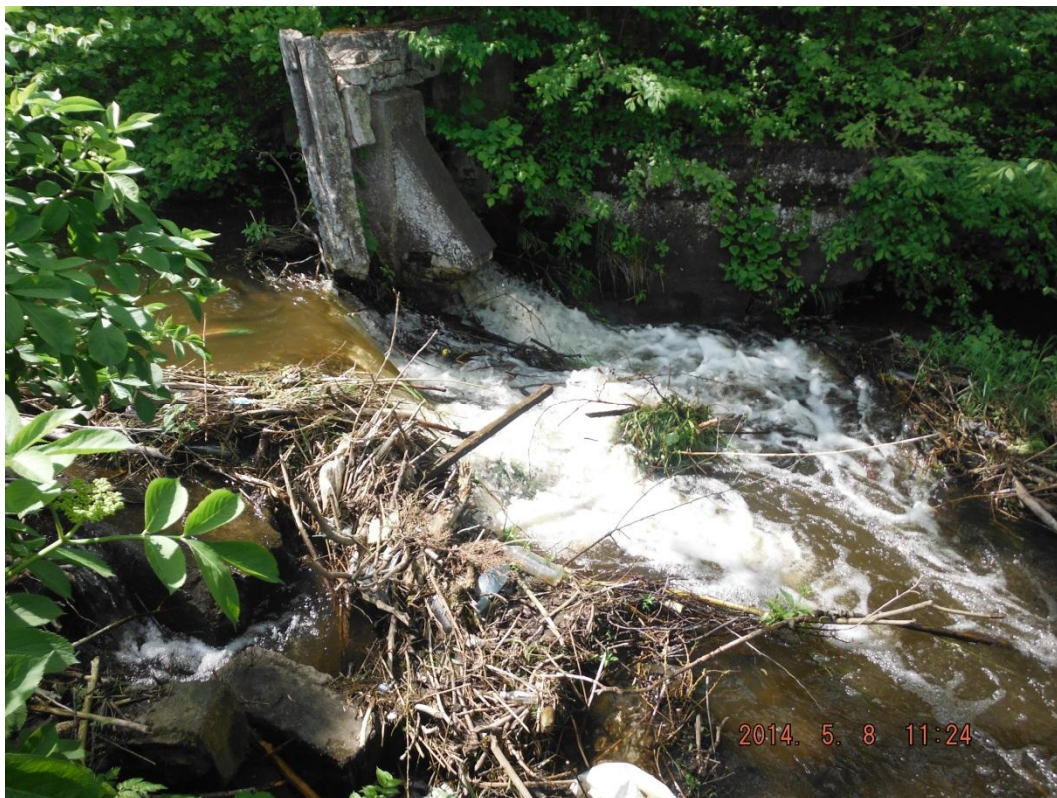
Rysunek 1 Uszkodzony jaz w km 11+790
